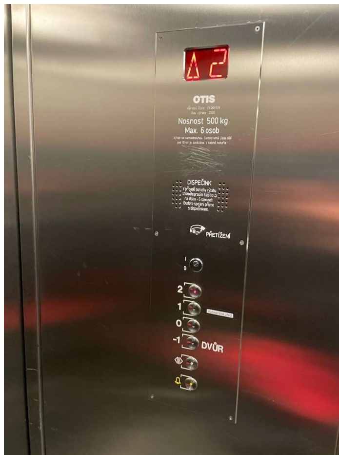
Obr. 5 – Ovládací panel výtahu
