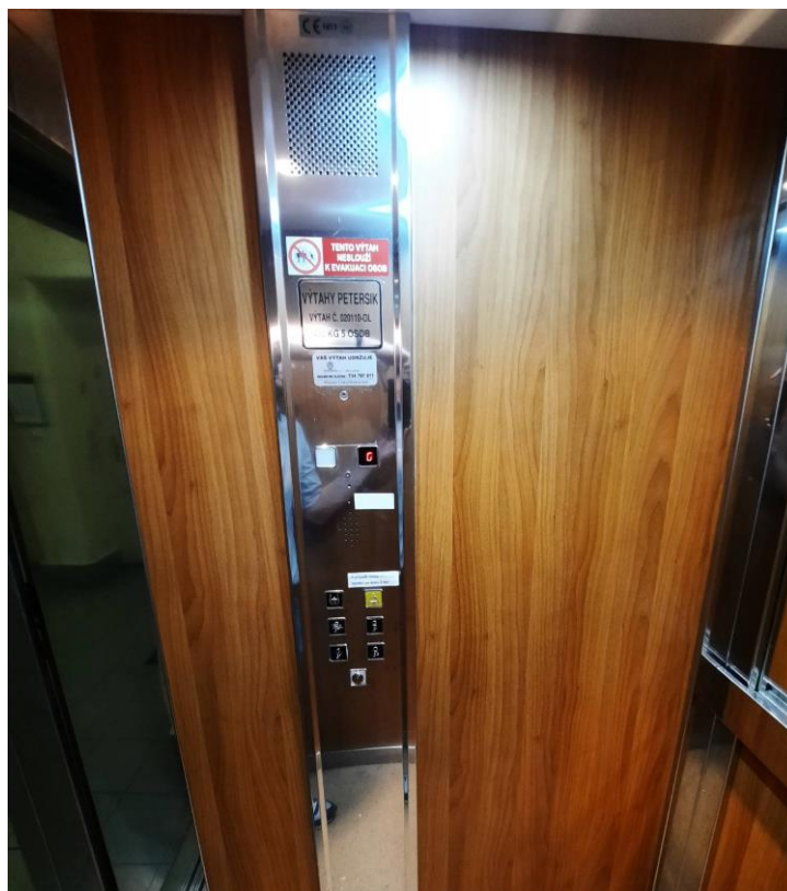
Obr. 11 Výtah – řídicí panel
