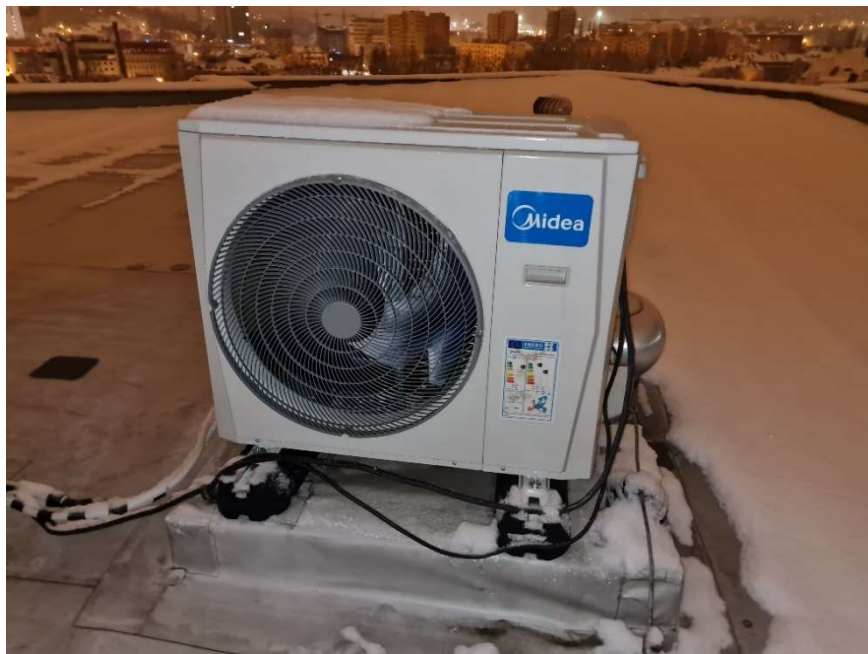
Výměník na střeše
