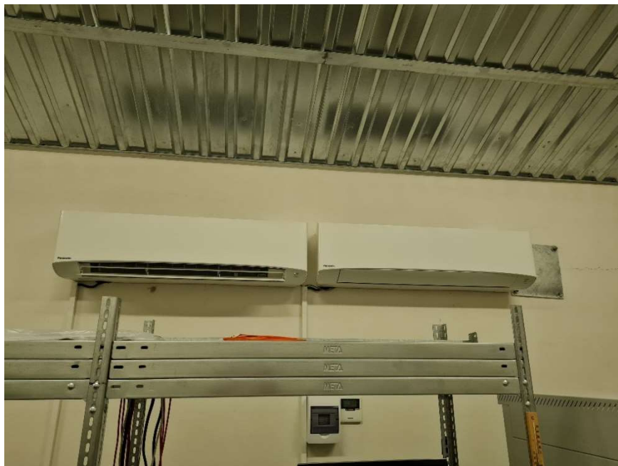
Vnitřní výměníky - 4. patro, serverovna
