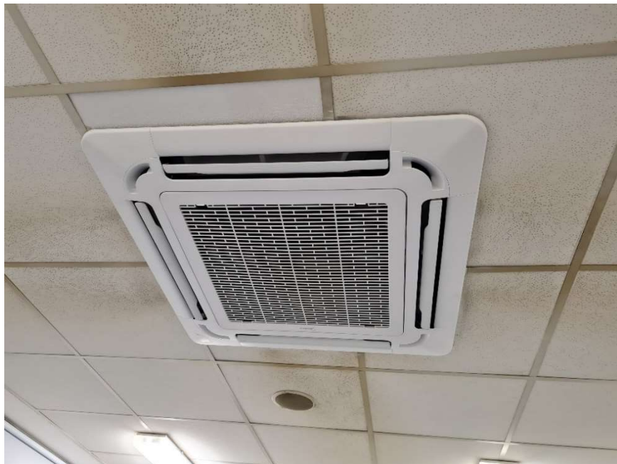
Vnitřní klimatizační jednotka ve velínu justiční stráže
