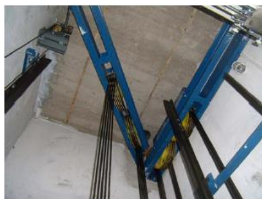
Pohled do hlavy šachty s převáděcími kladkami
