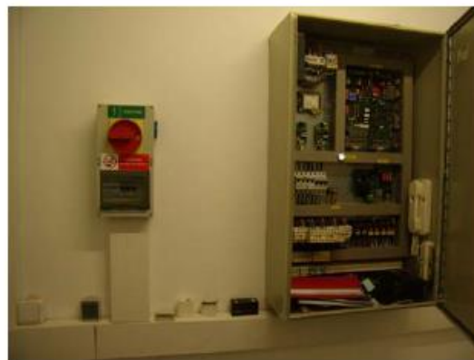
Hlavní vypínač a rozvaděč ve strojovně
