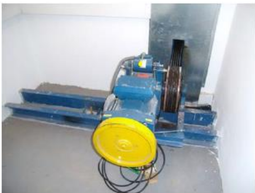
Poháněcí stroj na ocelovém roštu ve strojovně
